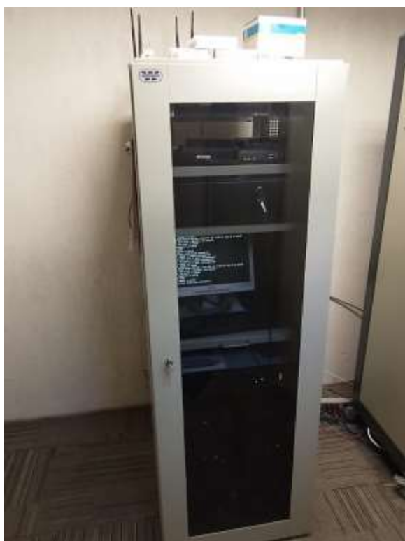
Figura 3 - Armário dos servidores
