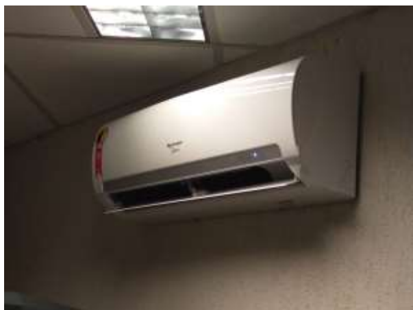
Figura 1 - Ar condicionado da sala dos servidores
