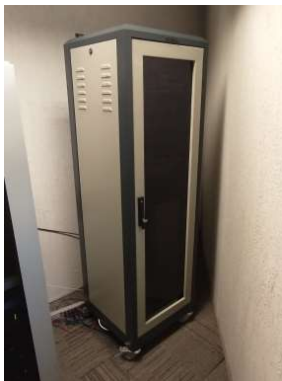
Figura 4 - Armário dos equipamentos de rede
